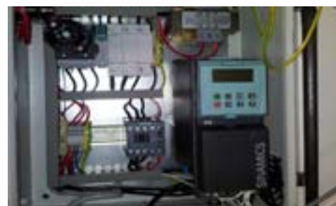
Quadro di controllo SIEMENS
